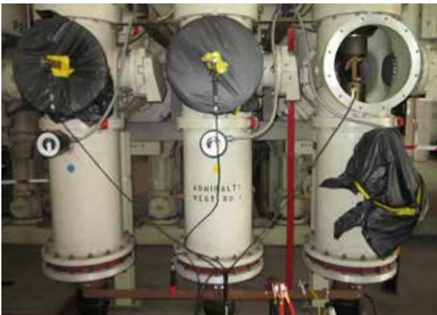
➤ Termination: Ang M. K. 66 kV Substation, SF 6
